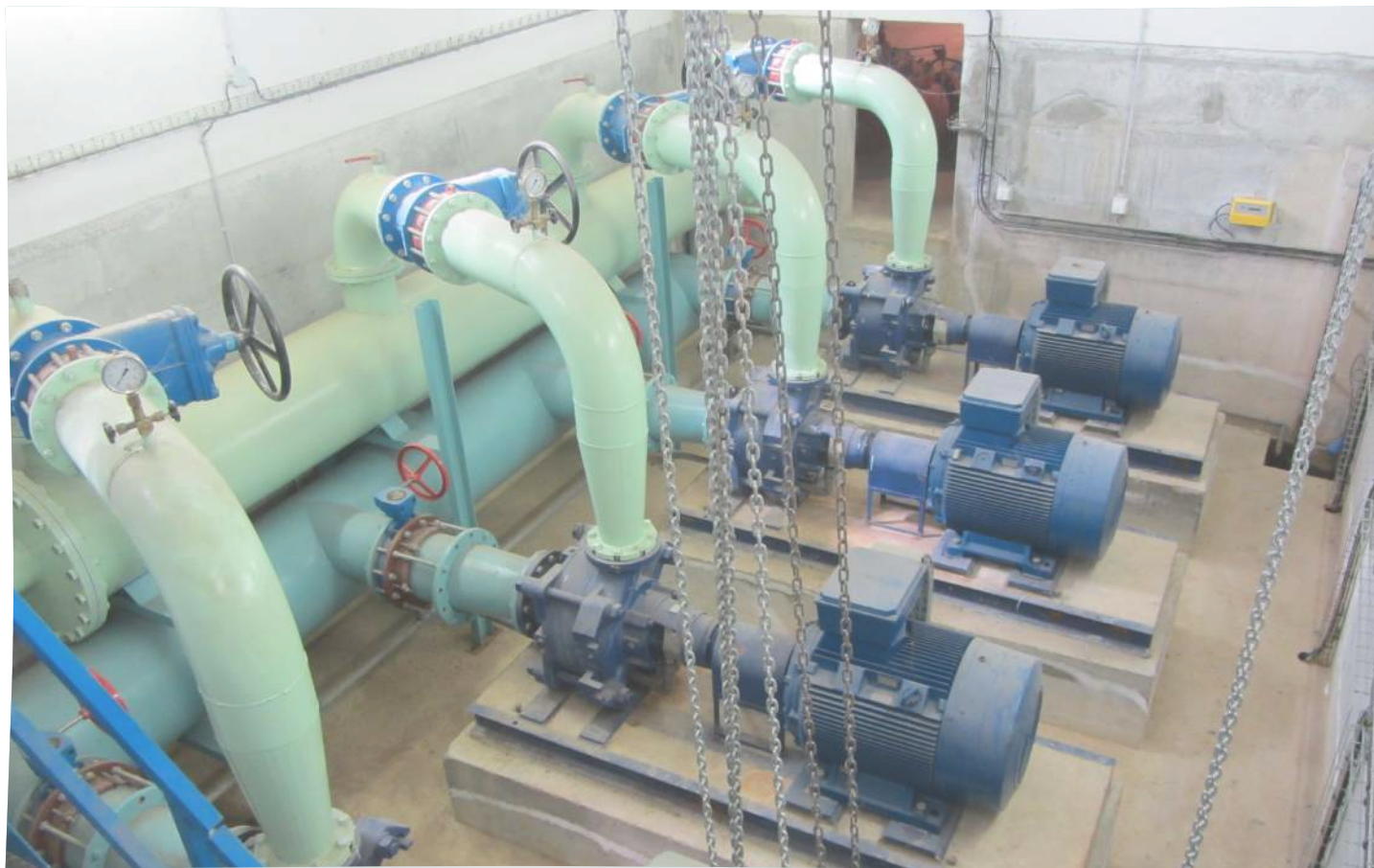
Station de pompage de Peyreras à l'Isle-sur-la-Sorgue
